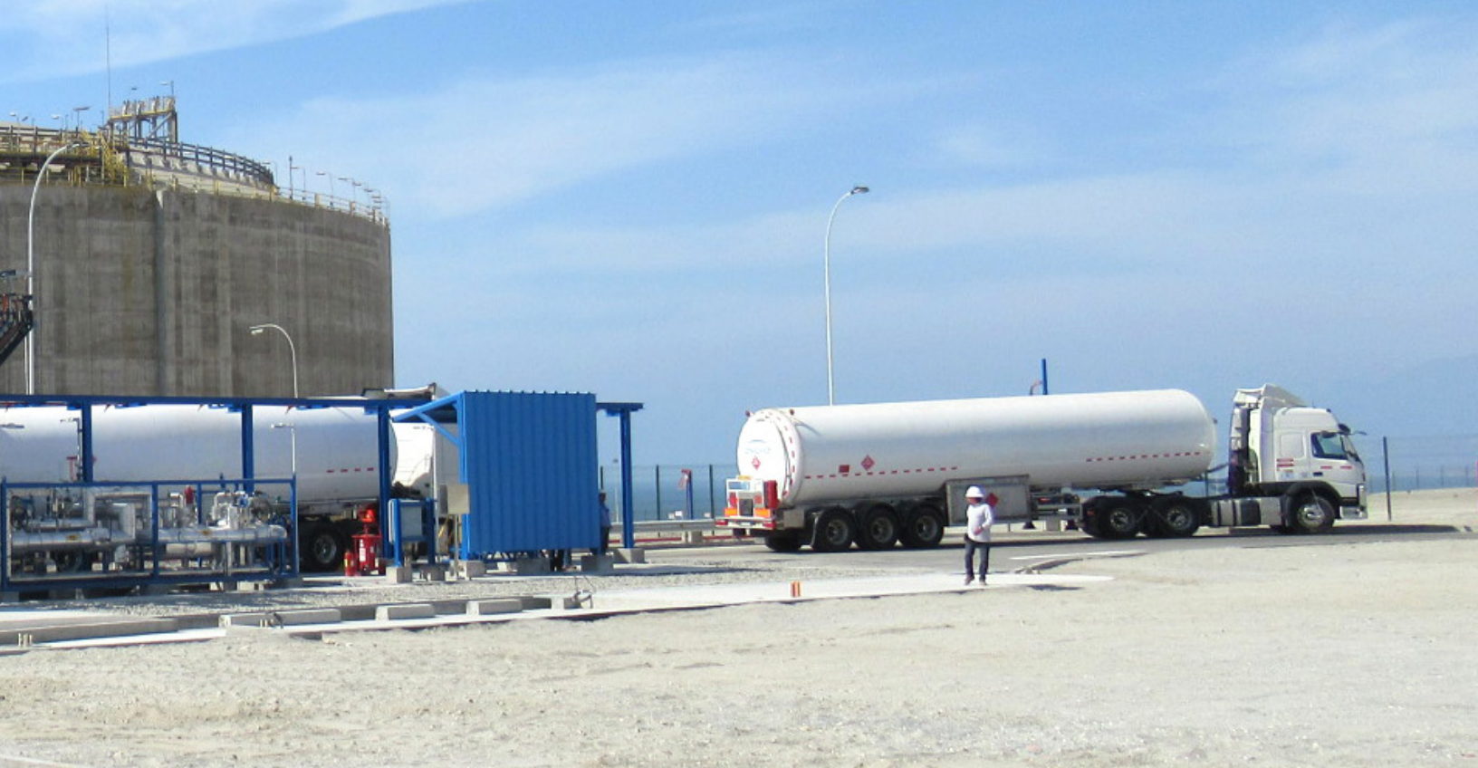
La nueva estación de carga de camiones cisterna permitirá que los clientes desde Arica a Copiapó reciban el GNL por carretera.
